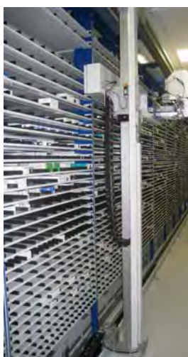
Blick auf die neue Kommissioniermaschine der Zentralapotheke
